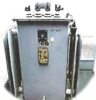
変圧器(トランス)
